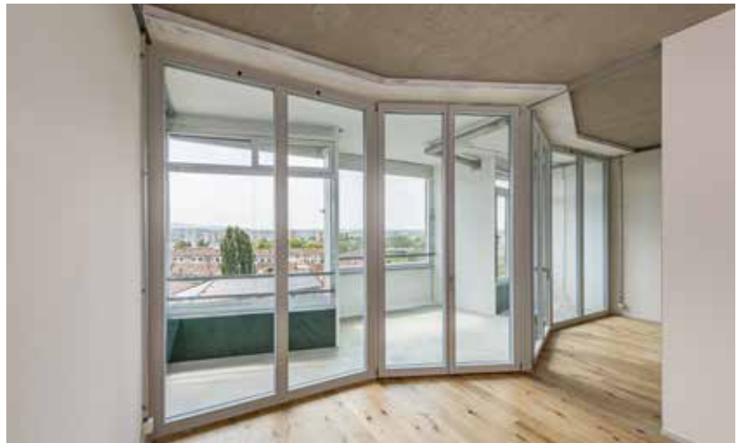
An der Südwestfassade wurde auf der Innenseite eine neue, ebenfalls geknickte und thermisch wirksame Glaswand eingebaut. Dadurch konnte die bauzeitliche Metall-Glas-Fassade maximal erhalten bleiben. Neben dem Ersatz einiger Festverglasungen durch Schiebegläser und dem Anbringen von Absturzsicherungen musste die Fassade nur gereinigt und an wenigen Stellen repariert werden. Der neue Zwischenraum dient nun als Loggia für die neuen Wohnungen.
