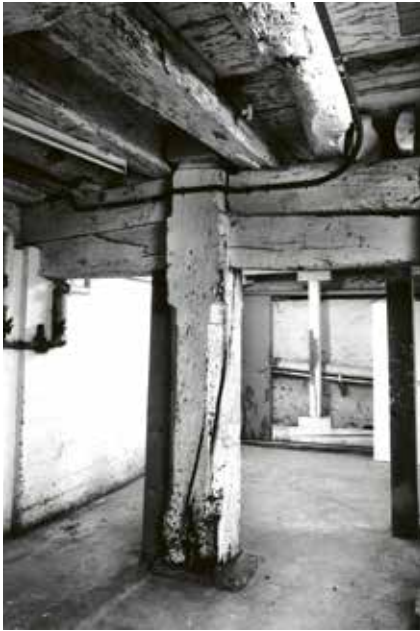
Stabile Konstruktion: Die Eichenstütze im Keller hat einen grösseren Durchmesser als gewöhnlich. Sie trägt einen Unterzug, auf dem die Deckenbalken sehr eng aneinander aufliegen.
